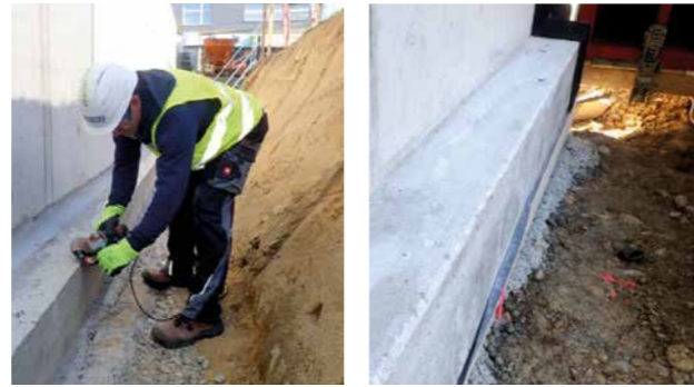
BRECHEN VON SCHARFEN KANTEN AN ALLEN ECKEN, ÜBER DENEN ABGEDICHTET WERDEN SOLL
